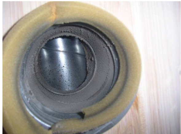
Poistoilmakanavissa oli jo pölyä.
