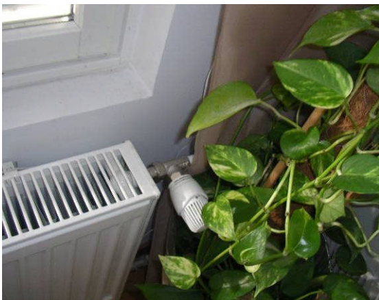
Pattereissa on termostaattiventtiilit.
