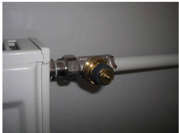
Patteriventtiilit ovat esisäädettyjä.
