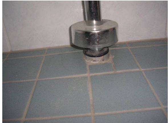
Käsienpesuallas kumitiivisteet olivat kunnossa.
