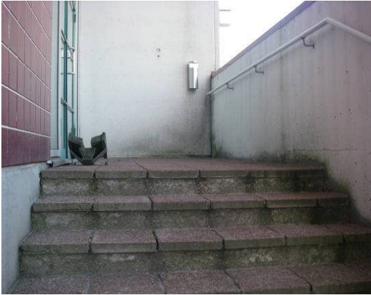
Porrashuone A kohdalla olevat ulkoportaat (otsapinnoissa rapautumista) sekä kaiteen maalipinnoissa kulumista.
