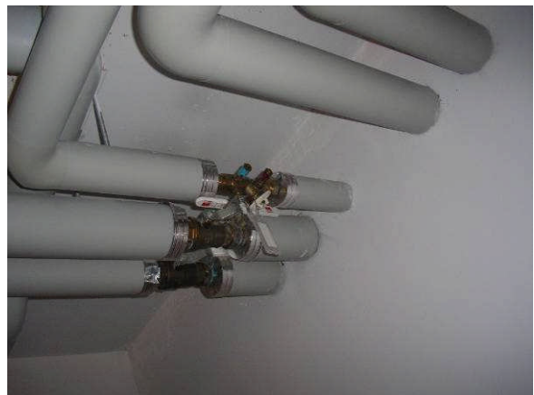
Linjaventtiilit ovat palloventtiilejä.
