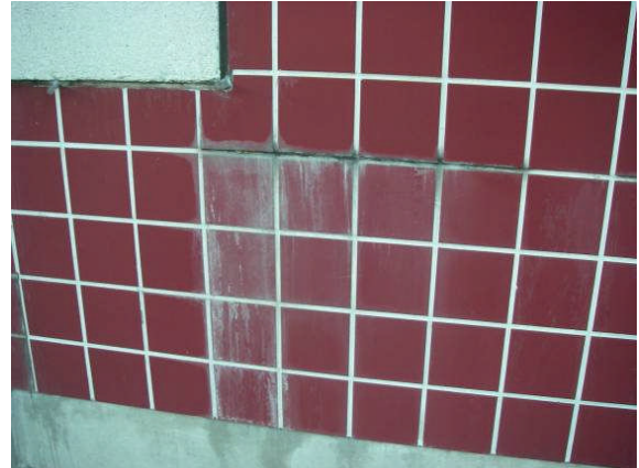
Porrashuone B ulkoporrastason kohdalta kaiderakenteen ulkopuolelta laatoitus irti alustastaan sekä kosteuden aiheuttamia jälkiä.
