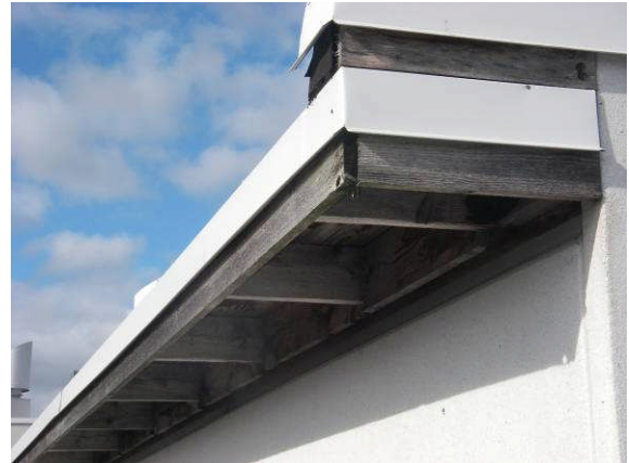
Ilmanvaihtokonehuoneiden räystäarakenteiden puuosissa huoltokäsittelyn tarvetta (kuva porrashuoneen B kohdalla, vesikaton puoleinen räystääs kokonaan maalaamatta).
