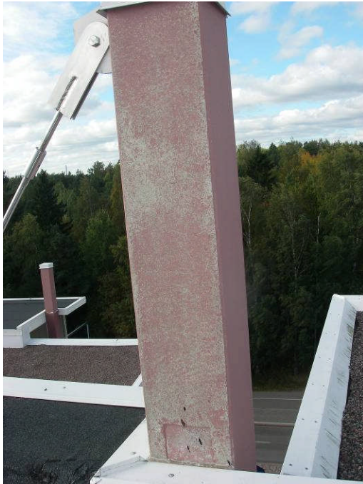
Parvekepilarin maalipinnoitteessa hilseilemistä / kulumista.
