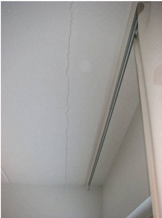
Kuva 6. Ontelolaatassa halkeama, kuva asunnosta B63.
