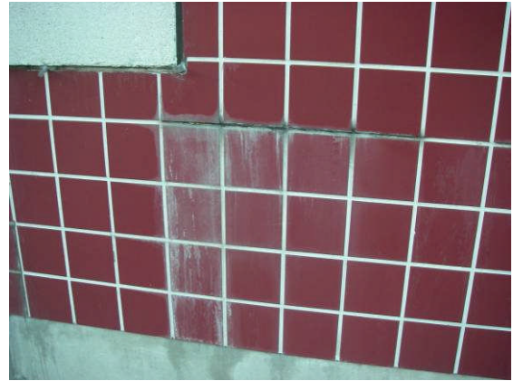
Kuva 4. Porrashuone B, ulkoporrastason kohdalta kaiderakenteen ulkopuolelta laatoitus irti alustastaan sekä kosteuden aiheuttamia jälkiä.
