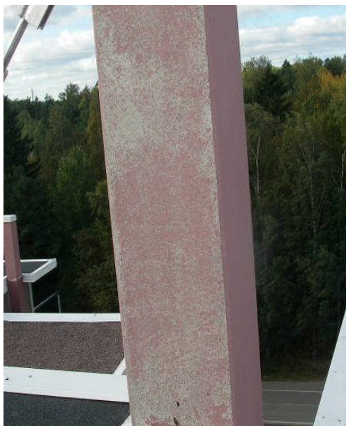
Kuva 5. Parveketornin nurkassa olevan betonipilarin maalipinnoite kulunut.
