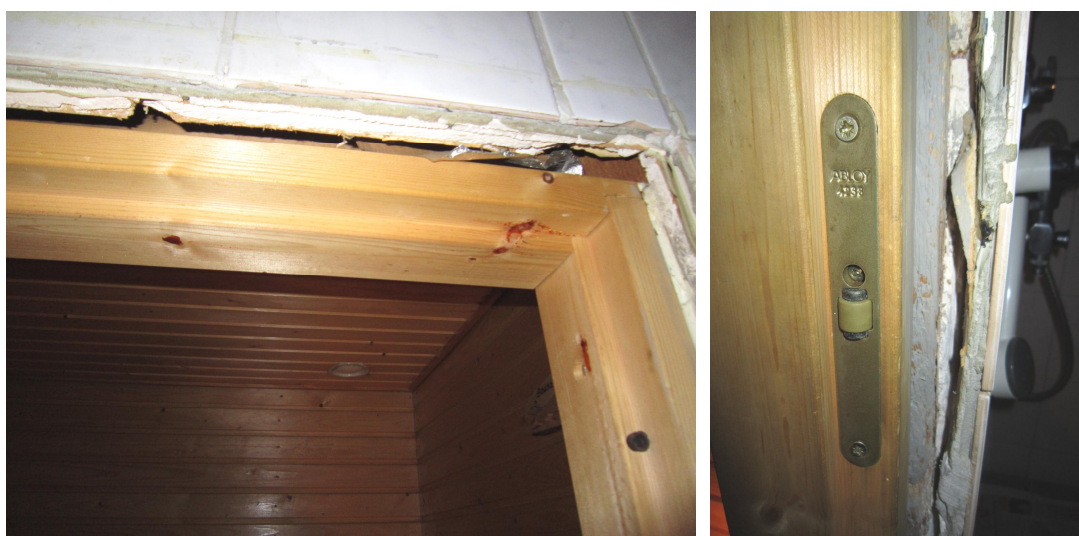
Kuva 4. Saunan oviaukko on tiivistämättä lattianrajaan asti. Oikeanpuoleisessa kuvassa näkyy seinärakenteessa käytettyjä materiaaleja.
