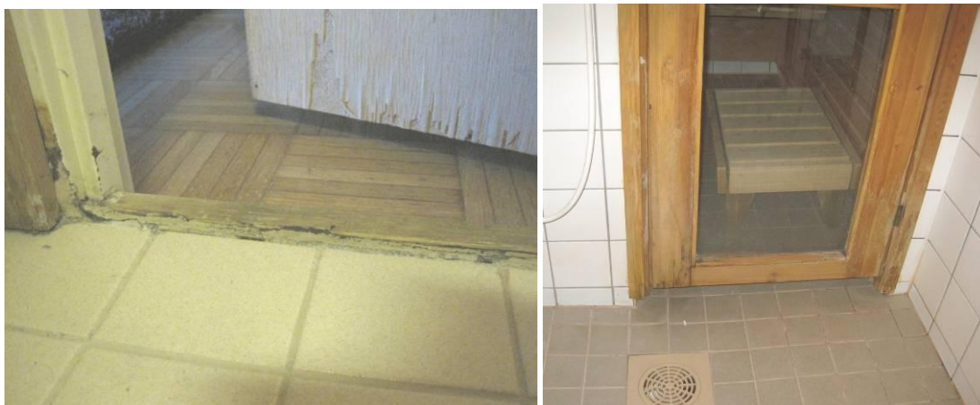
Kuva 6. Alkuperäiset kylpyhuoneiden ovet olivat usein alareunastaan turvonneita ja niiden lakkaus irtoili. Oikean puolimmaisessa kuvassa saunan ovi.
