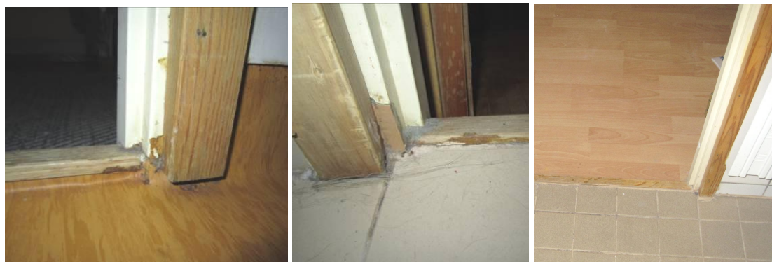
Kuva 3. Vasemman puoleisessa kuvassa on alkuperäisen kylpyhuoneen kynnyks. Kaksi muuta kuvaa ovat kylpyhuoneista, joista laatoituksen alle jätetty muovimatto. Näissä kynnyksen korkeus on niukka.
