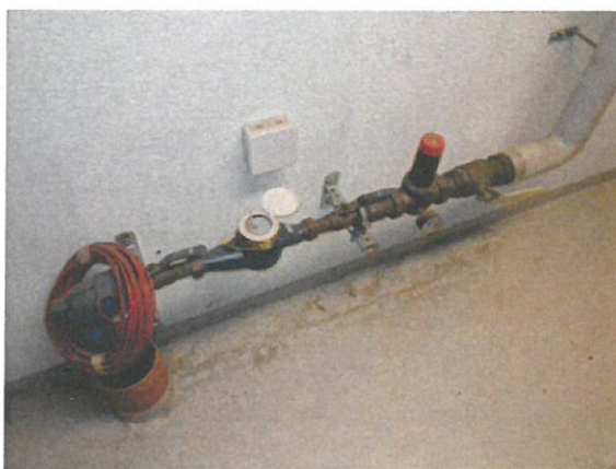
19. Päävesimittari ja vakiopainesäädin.
