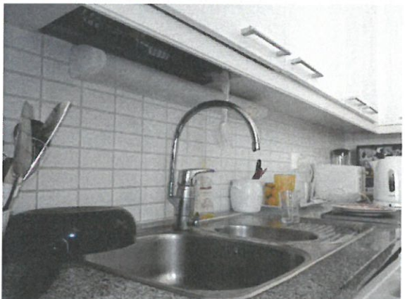
48. Keittiön välitilan valaistusta, T8- loisteputki.
